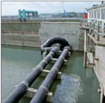
Deniz suyu tuz giderme tesisinin boru hatları
