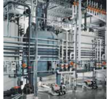
SIMONA®PVDF boru hatlarıyla kimya tesisi
