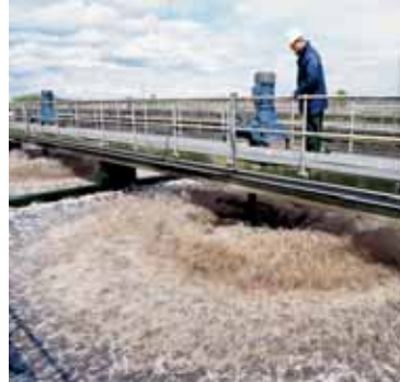
Arıtma tesisinde SIMONA®PE 100 boru sistemleri
