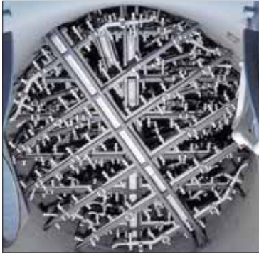
Baca gazı kükürt giderme sisteminde püskürtme boruları
