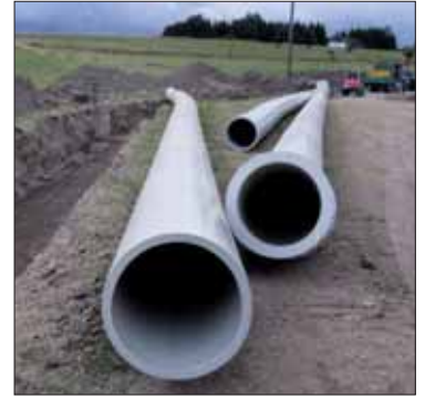
Sınai atıksu hattı
